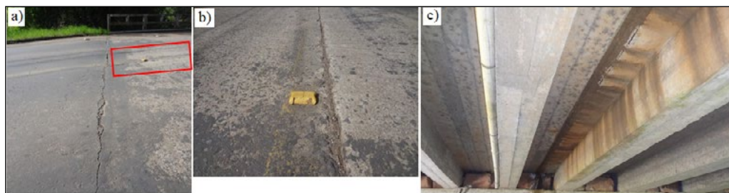
Figura 12 – Juntas a) acesso a ponte; b) longitudinal; c) infiltração ao longo da junta longitudinal
