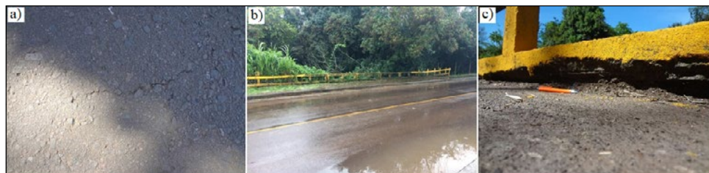
Figura 16 – a) trinca e desgaste do pavimento asfáltico; b) acúmulo de água sobre a pista; c) deslocamento do concreto do guarda-corpo
