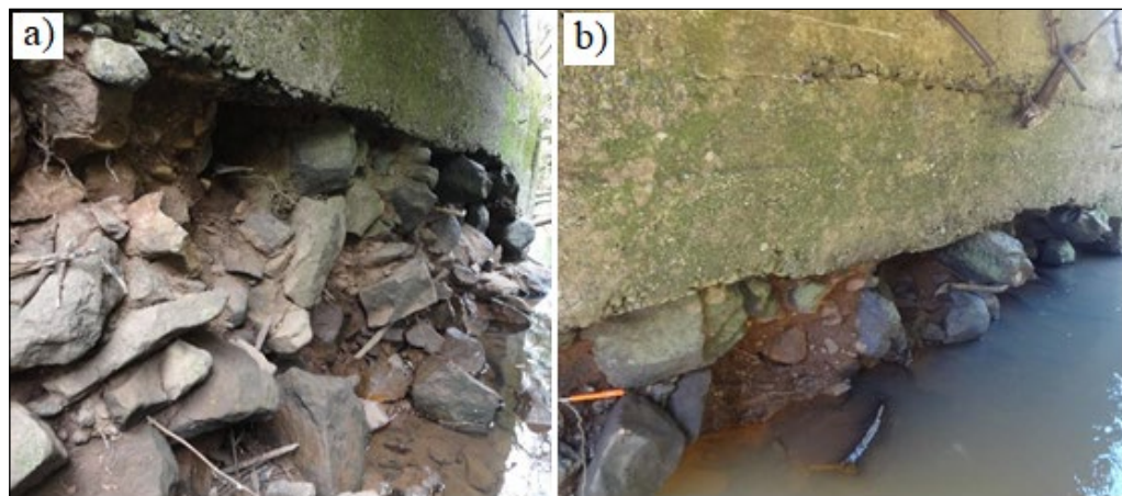
Figura 7 – Erosão na base da fundação
