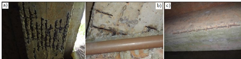
Figura 13 – a) nichos de concretagem; b) estribos aparentes; c) armadura longitudinal aparente
