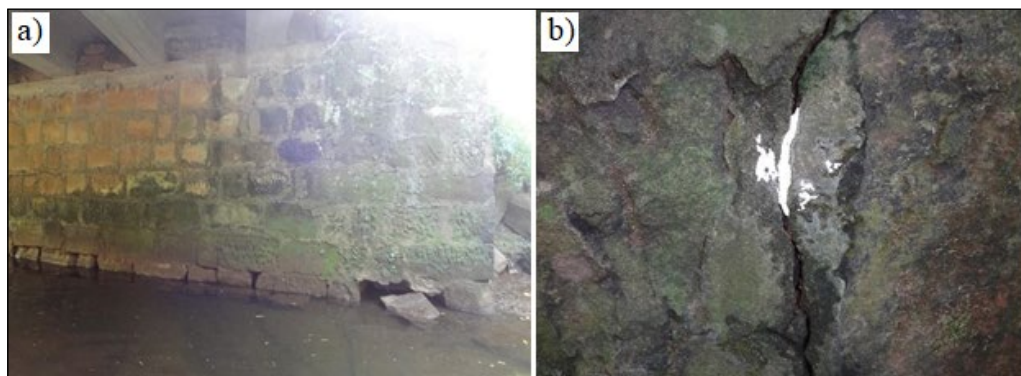
Figura 14 – Encontros a) desprendimento de blocos de pedra; b) fenda com aplicação de gesso
