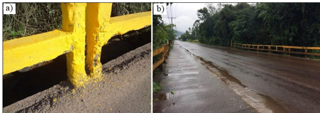
Figura 9 – a) guarda corpo em concreto com perda de seção; b) acúmulo de água na pista
