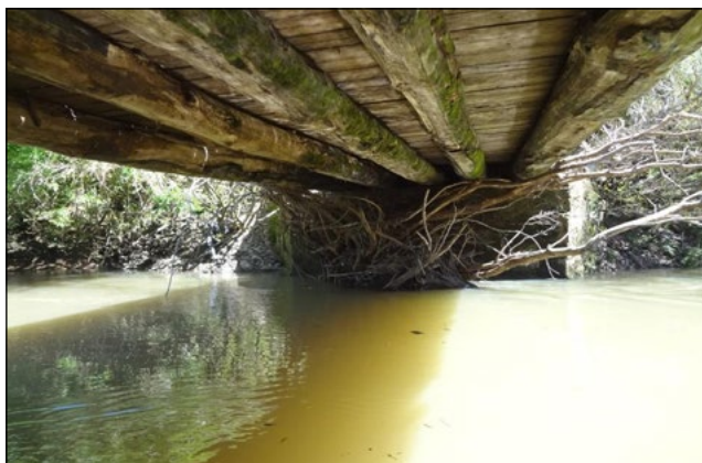
Figura 6 – Acúmulo de materiais junto aos encontros
