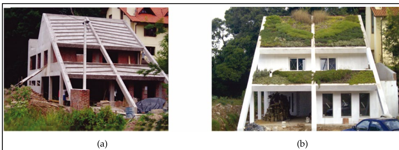
Figura 3 - Estrutura espinha de peixe, para evitar o deslizamento do substrato (a) e cobertura pronta (b)
