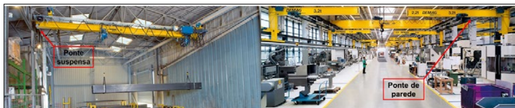
Figura 1 - Ponte rolante suspensa e de parede
