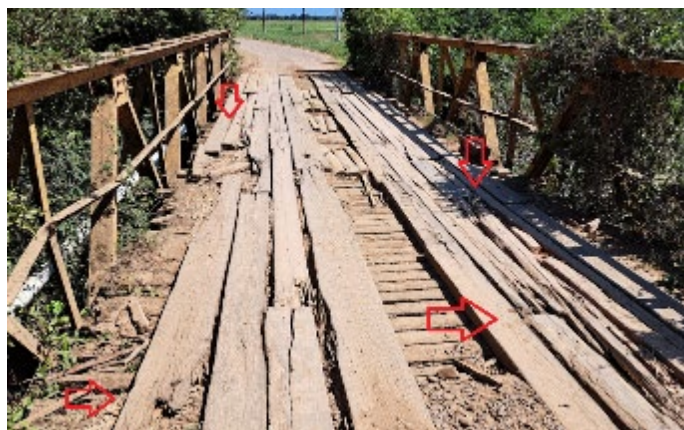
Figura 10. Vista do tabuleiro da ponte com danos severos
