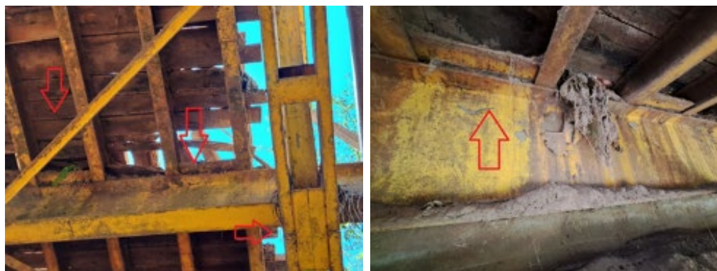
Figura 8. Vista da parte inferior da ponte 02: (a) danos no tabuleiro e corrosão, (b) corrosão nos componentes de aço
