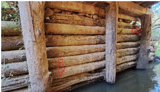
Figura 5. Perda de seção e fissuras na ponte 01
