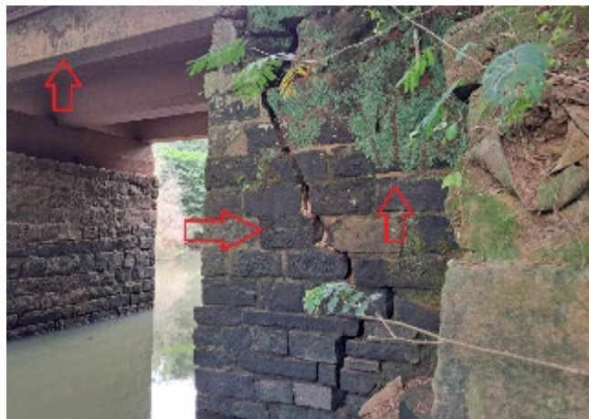
Figura 13. Diversas manifestações patológicas encontradas na ponte 03
