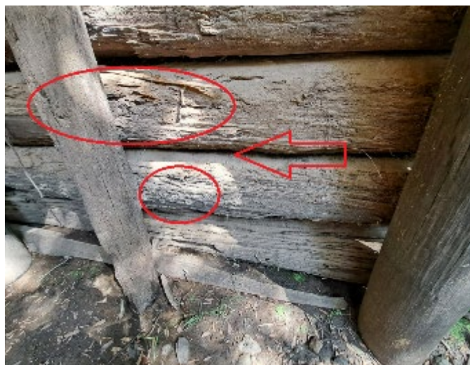
Figura 3. Danos causados por insetos em peças de madeira
