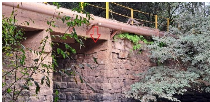
Figura 12. Fissura no encontro da ponte 03
