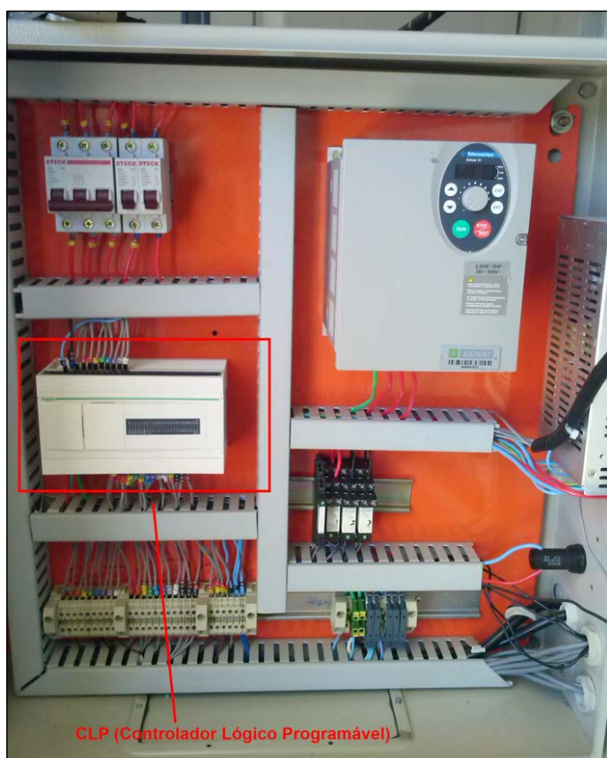
Figura 7 – CLP (Controlador Lógico Programável - TWIDO – SCHNEIDER ELETRIC)
