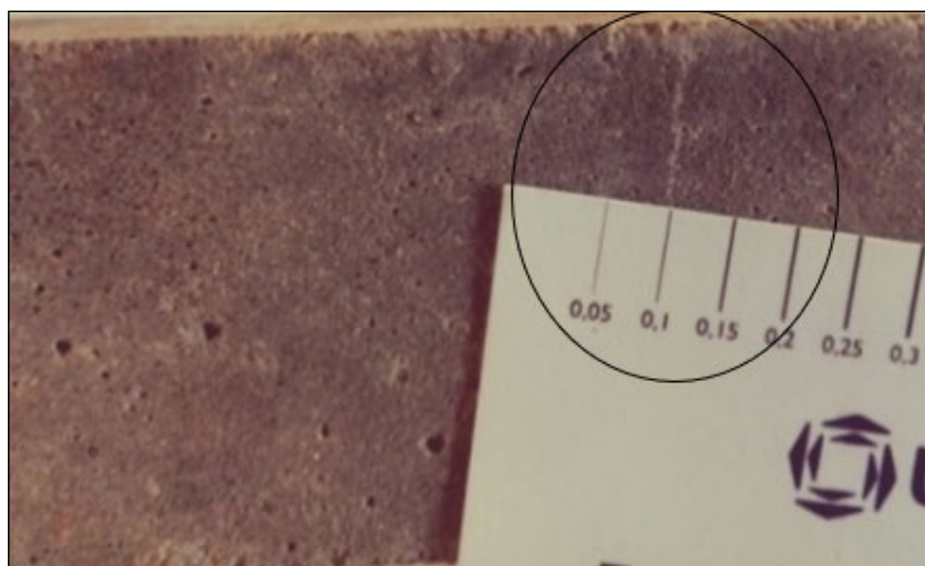
Figura 05 – Cicatrização de fissura aos 42 dias
