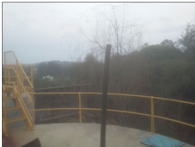
Figura 1 – Tubulação de saída de biogás, localizada na parte superior do reator de tratamento de efluentes anaeróbio 1
