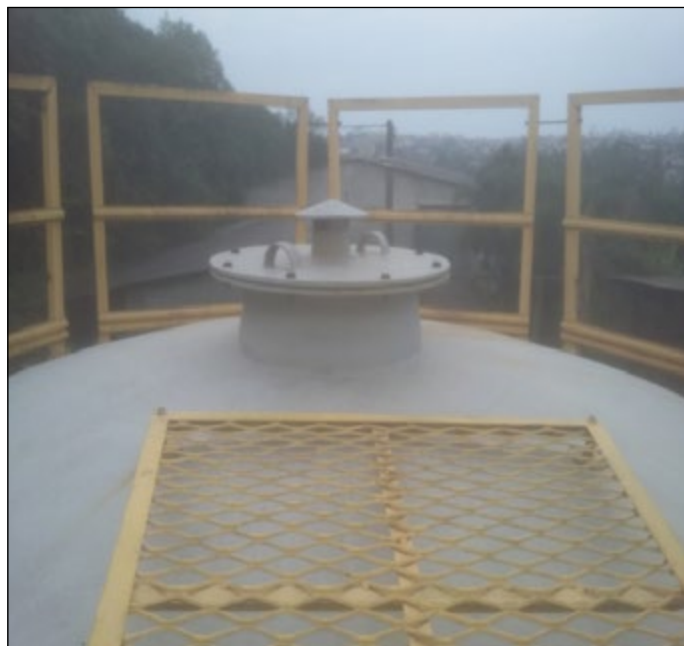
Figura 3 – Tubulação de saída de biogás, localizada na parte superior do reator de tratamento de efluentes anaeróbio 2
