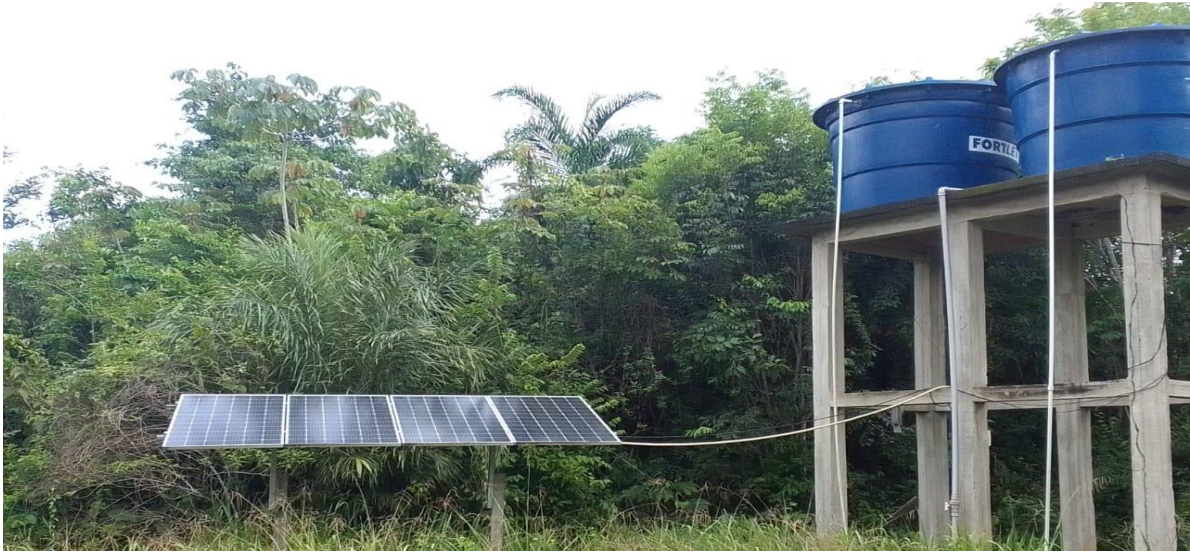
Figura 18 – Sistema fotovoltaico da EFAC.
