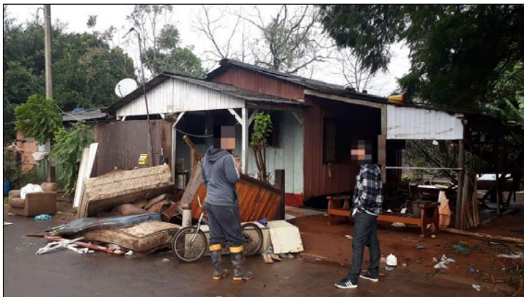
Figura 4 - Visita do aluno à sua casa para avaliar os danos causados pela enchente (2020).
